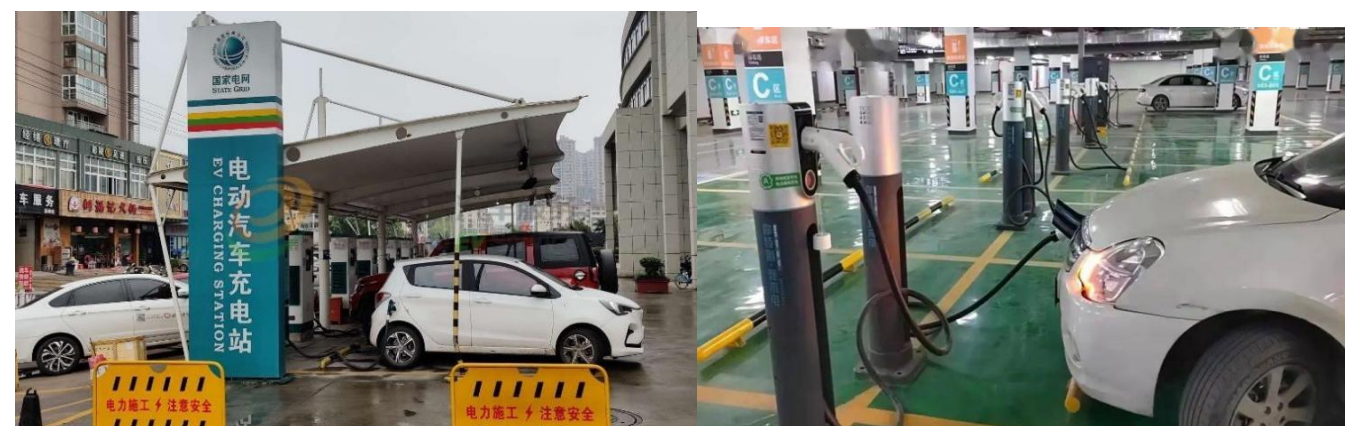
图3-3 直流充电站、交流充电站
